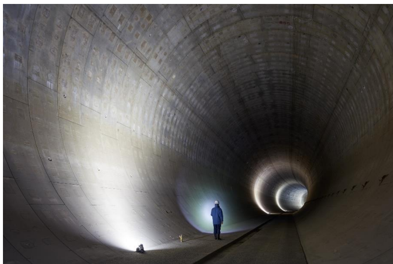
写真 2-2 神田川・環状七号線地下調節池
