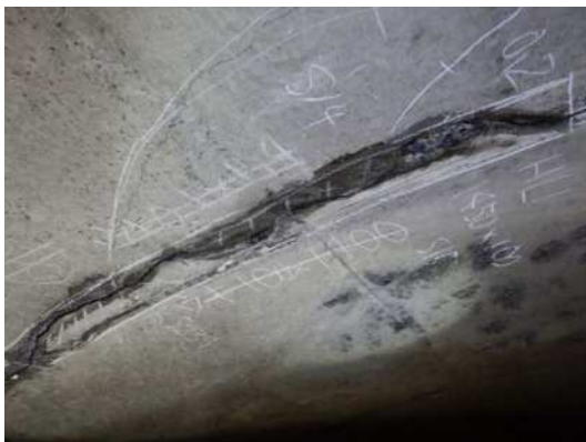
写真-19 うき(堀之内第三トンネル)
