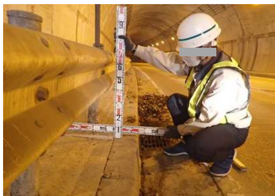
写真-15 異常時点検(ガードレール支柱腐食)
