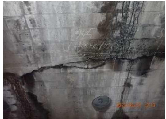
写真-18 ひび割れ（大麦代トンネル）
