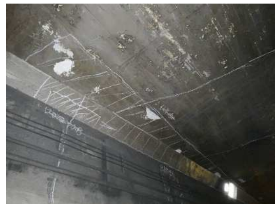
写真-22 ひび割れ(日比谷地下自動車道)
