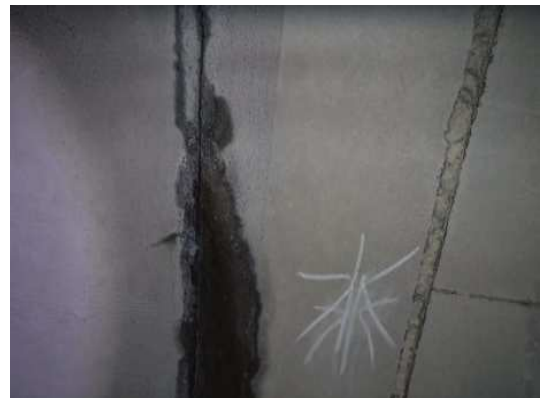
写真-20 漏水(岡田トンネル)
