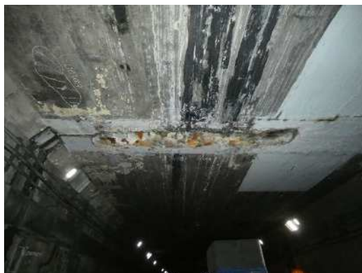
写真-21 うき(日比谷地下自動車道)
