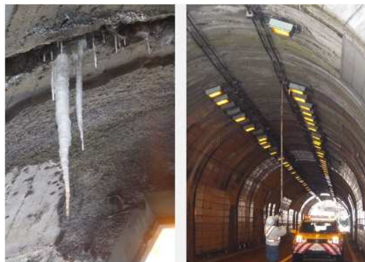
写真-16 応急措置(つららの除去)
