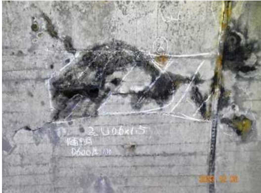
写真-17 うき(吹上トンネル)
