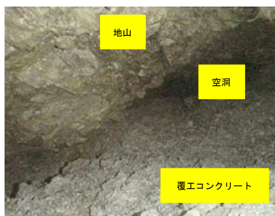
写真-4 覆工コンクリート背面の空洞
