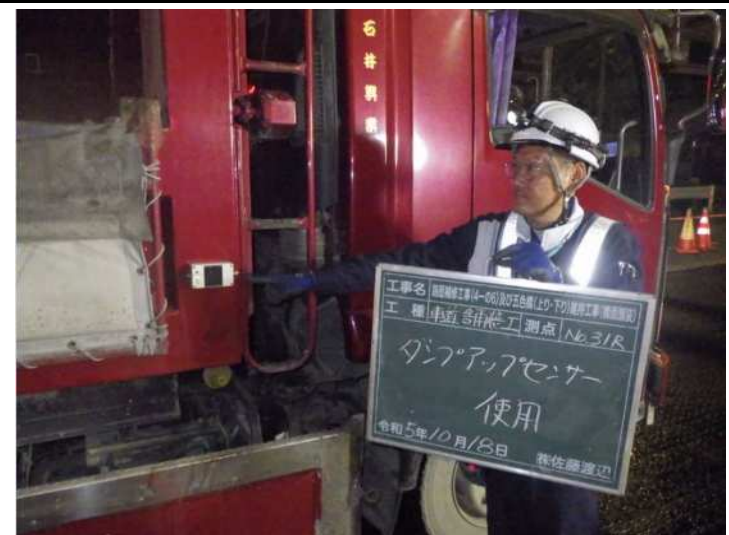
ダンブアップセンサー(荷台角度警報装置)の使用状況
