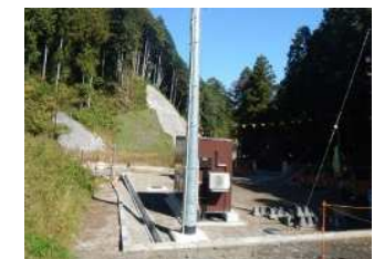
自動調光盤据付
