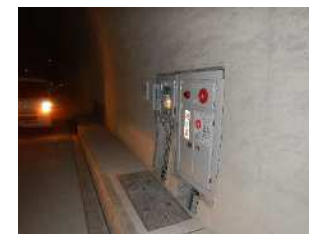
坑内ハンドホール
