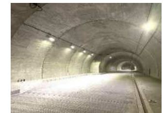
トンネル照明点灯状況
