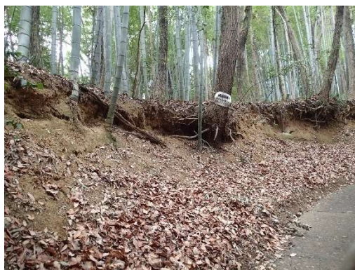
天野坂付近：土砂流出、根が露出
