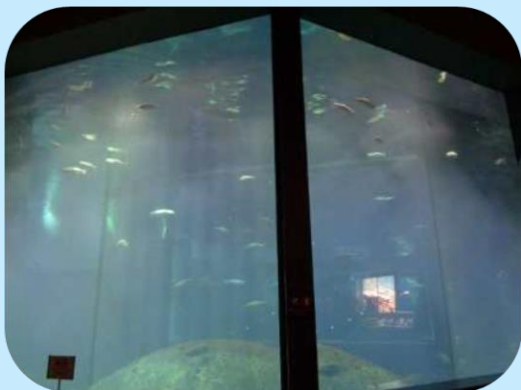
アクリルの白濁、接着部の劣化
