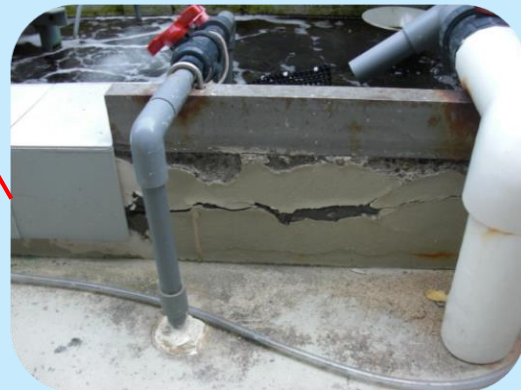
コンクリート（水槽）の劣化
