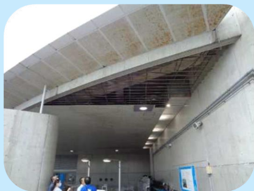
天井下地の腐食 ※R5.3現在改修済
