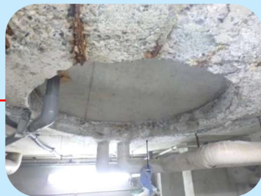
鉄筋の腐食、コンクリートの劣化
