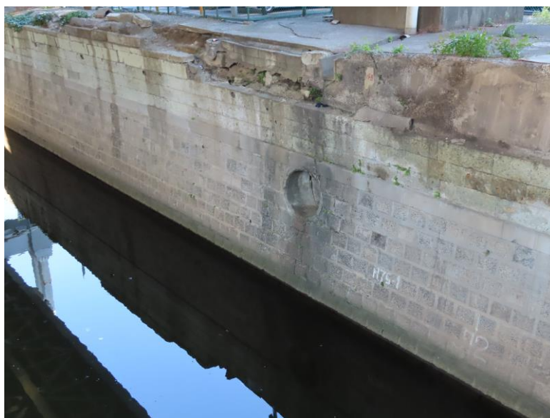
写真 2 - 9 古川の護岸が老朽化した状況
