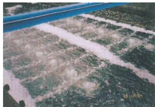
(水質浄化装置稼働状況)
