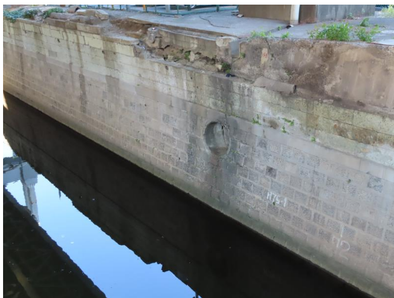
写真 2－9 古川の護岸が老朽化した状況
