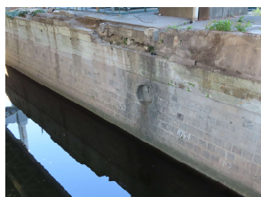
護岸の老朽化（古川）
