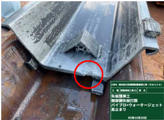
③鋼矢板欠損状況
