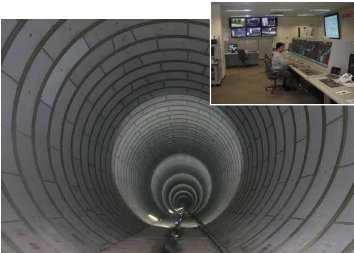
神田川・環状七号線地下調節池(稼働中) 本体トンネルと遠方監視操作システム 神田川、善福寺川および妙正寺川の3河川から洪水を取水して、このトンネル内に貯留します。 各河川の水位監視や取水の際のゲート操作等は、善福寺川取水施設の監視室で行います。
