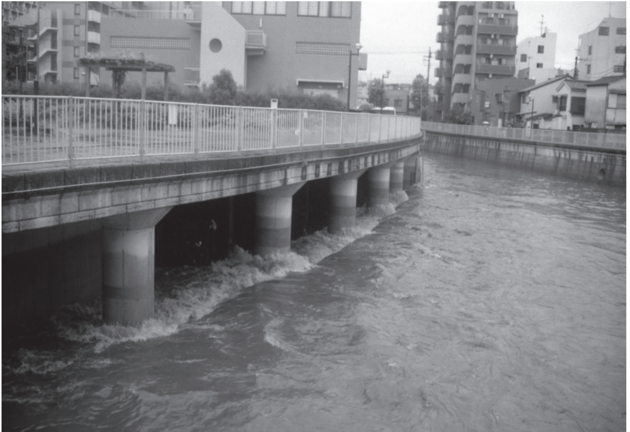
神田川・環状七号線地下調節池への流入（神田川取水口）
