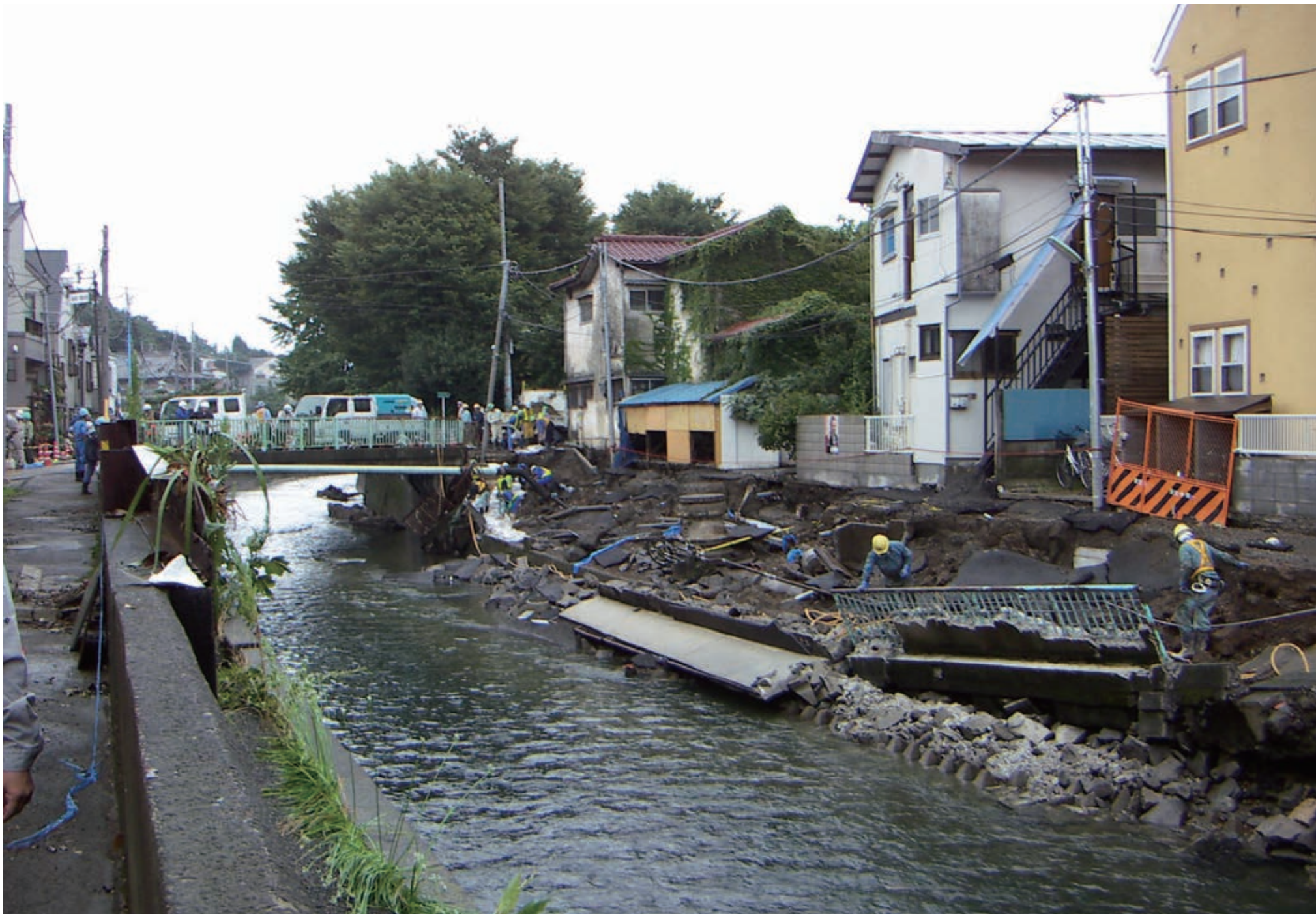
平成 17 年 9 月 4 日集中豪雨（杉並区にある下井草観測所で 1 時間あたり 112mm の雨量を観測。5,827 棟の浸水被害が発生した。） 写真：妙正寺川
