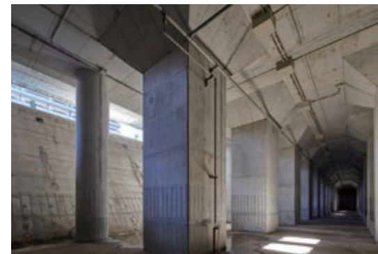
地下箱式の取水口
