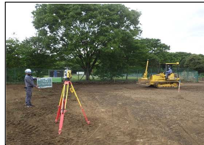
播種（土工事）（TS測量によるブルドーザー敷均し測定管理）
