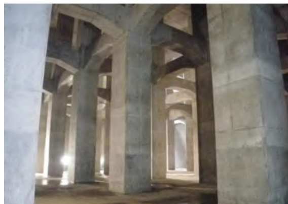
地下箱式（善福寺川調節池）
