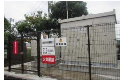
災害に備えた非常用発電機
