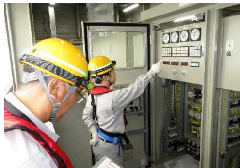
電気設備点検
