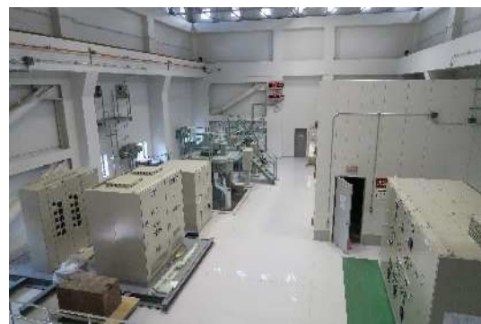
耐震対策後の機場内ポンプ設備
