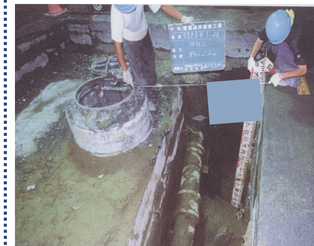
発見された空洞の開削調査
