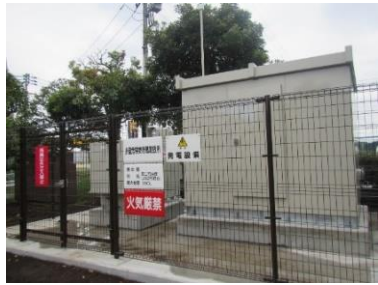
非常用発電機
