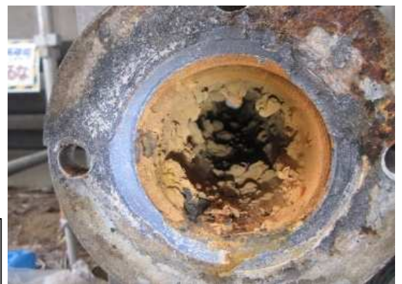
写真-2 配管内の腐食状況
