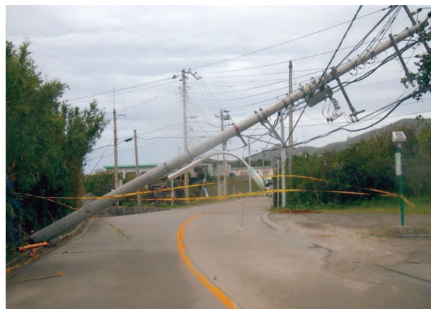
令和元年台風15号の影響による電柱倒壊(新島村 若郷地区)
