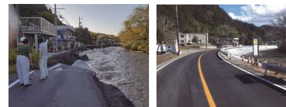
被災状況 復旧状況
