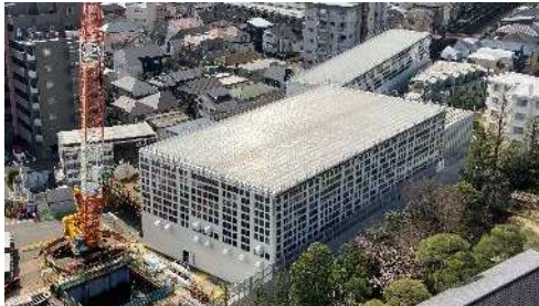
妙正寺川取水施設の防音ハウス
