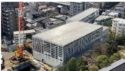
妙正寺川取水施設の防音ハウス
