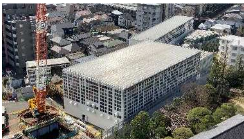
妙正寺川取水施設の防音ハウス
