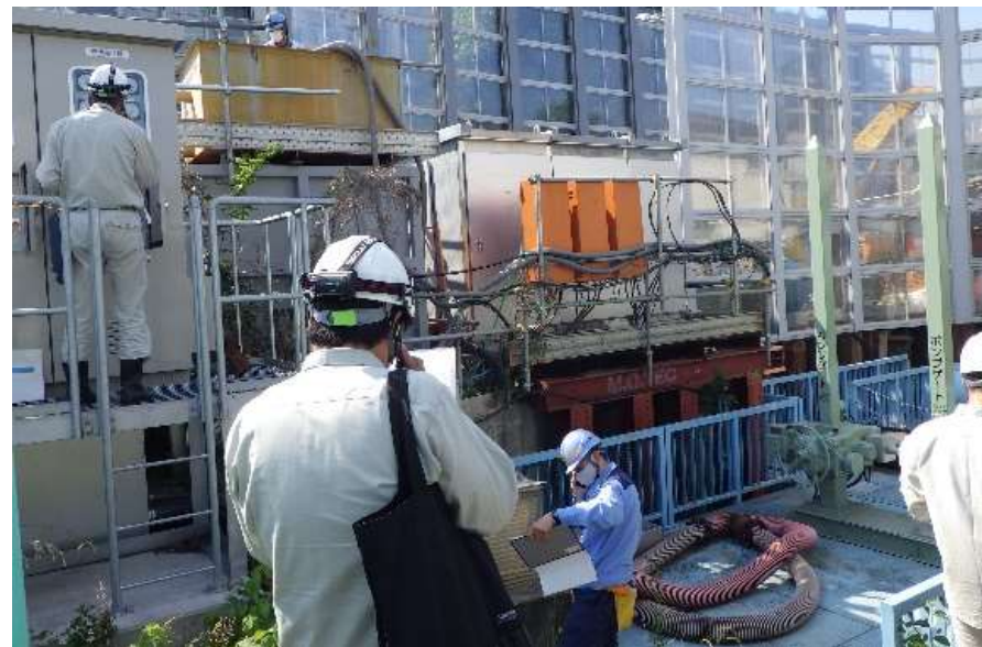
操作盤でのゲート操作状況
