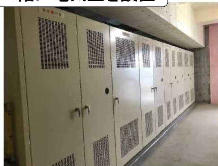
4階に電気室を設置
