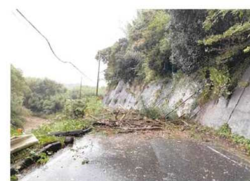
国道465号(補助国道)法面崩壊状況
