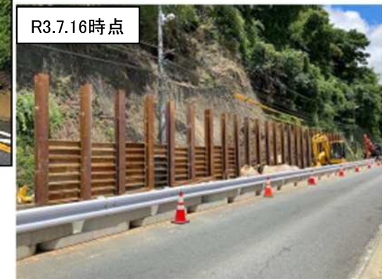
国道246号(神奈川県松田町松田惣領地先)における崖崩れの状況
