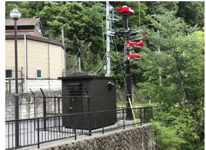
▲放流警報用のサイレンとスピーカー
