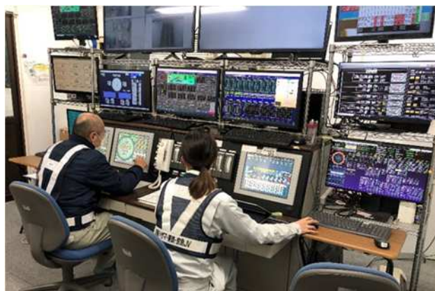
シールドマシン中央制御室
