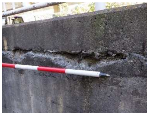
④ はく離・鉄筋露出 (ランク 1 相当)
