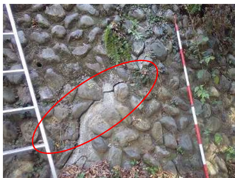
① ひび割れ (ランク 1 相当)
