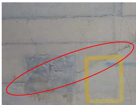
② ひび割れ (ランク 2 相当)
