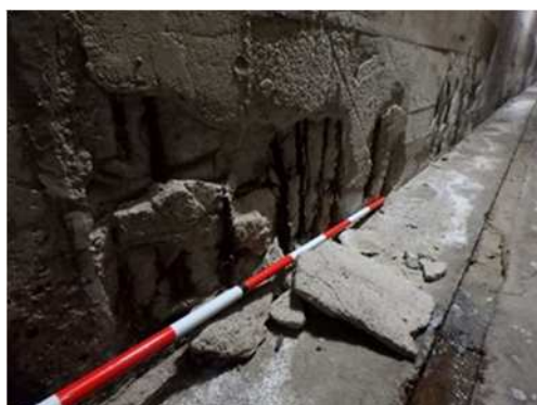
① うき・はく離・鉄筋露出 (ランク1相当)
