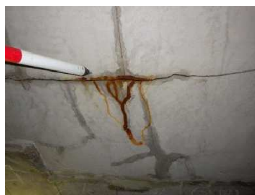
⑤ 補修箇所の再劣化（にじみ） (ランク2相当)
