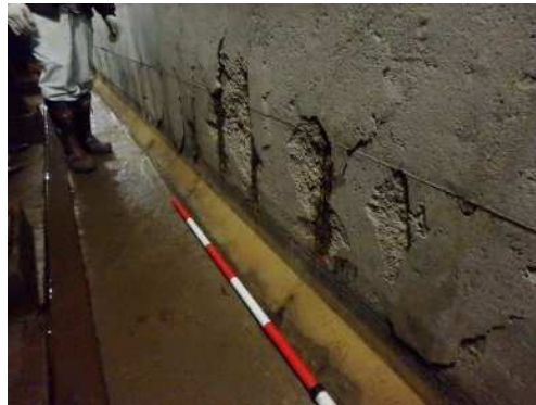
② うき・はく離・鉄筋露出 (ランク1相当)
