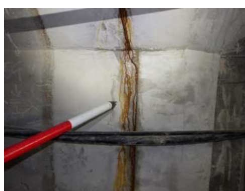
⑥ 補修箇所の再劣化（漏水） (ランク2相当)
