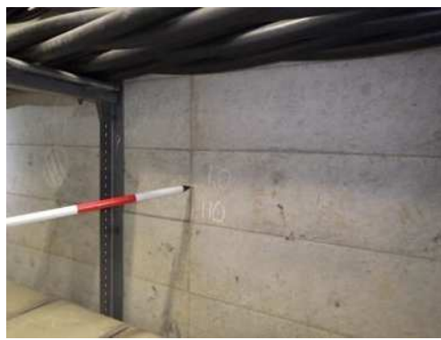
④ ひび割れ (ランク2相当)
