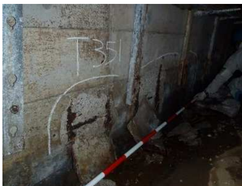
③ はく離・鉄筋露出・漏水 (ランク1相当)
