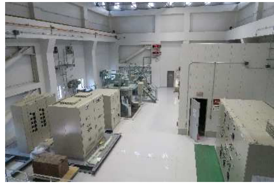
耐震対策後の機場内ポンプ設備
