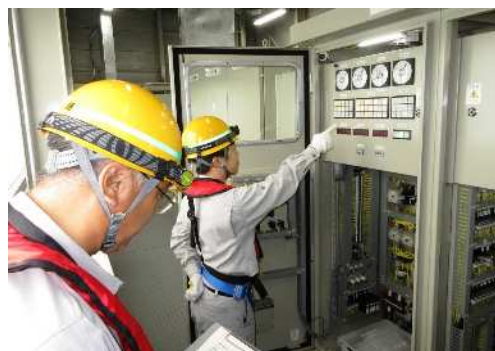
電気設備点検
