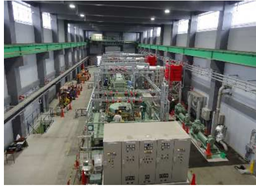
耐震対策後の機場内ポンプ設備
