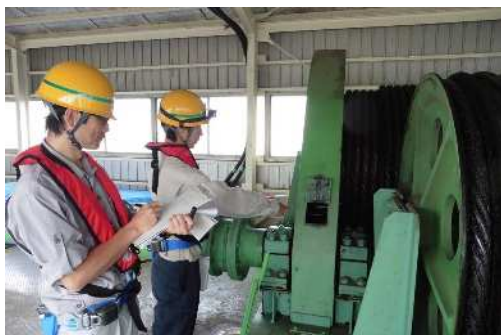
水門上屋設備点検
