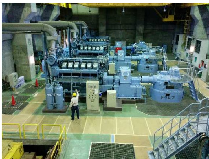
木下川排水機場内部
