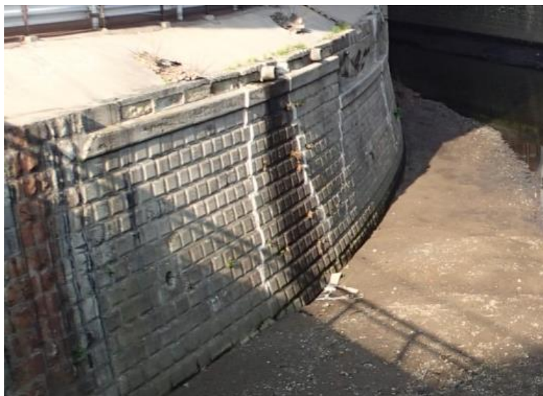
写真 2－9 古川の護岸が老朽化した状況
