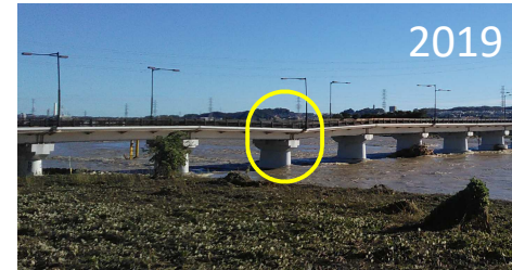
令和元年台風第19号で洗堀被害
