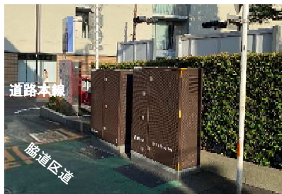
写真-3 脇道区道上の地上機器
