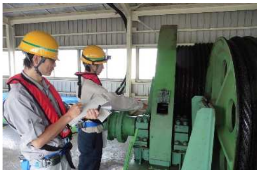
水門上屋設備点検
