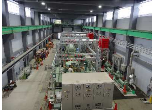
耐震対策後の機場内ポンプ設備
