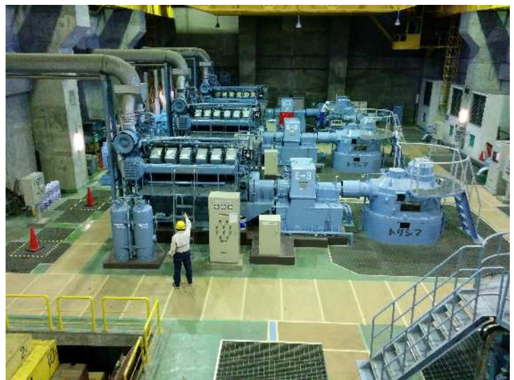
木下川排水機場内部
