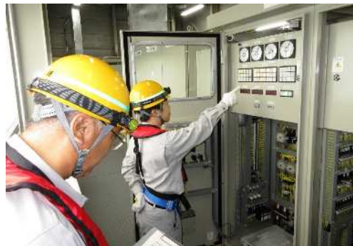
電気設備点検
