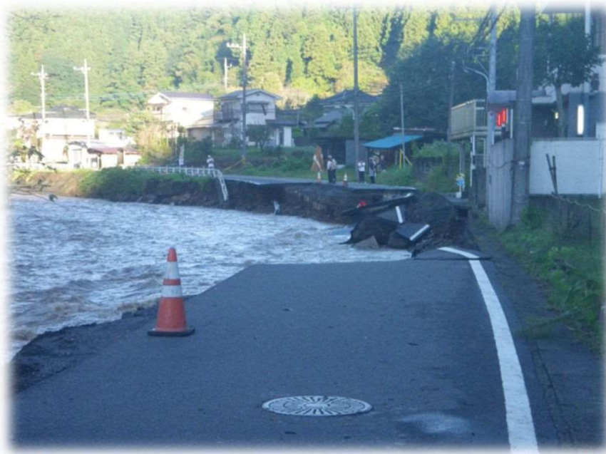
都道崩落現場(下流側から)
