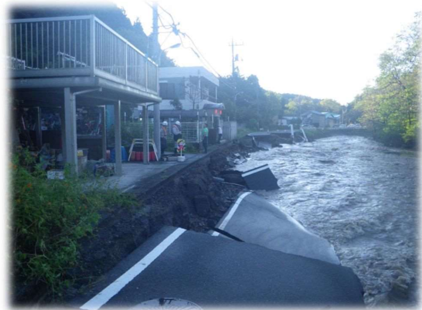
都道崩落現場(上流側から)
