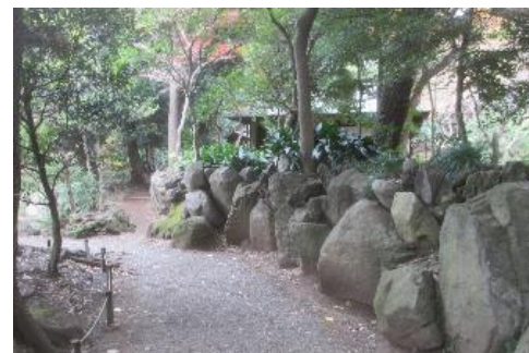
図2-173 崩れ石積 平成30（2018）年12月10日
