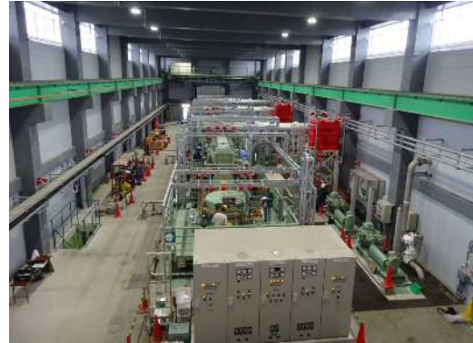
耐震対策後の機場内ポンプ設備
