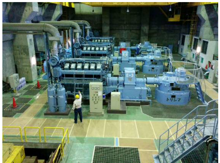
木下川排水機場内部
