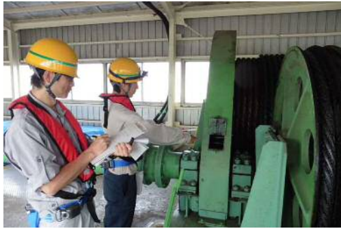
水門上屋設備点検
