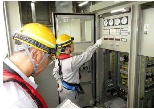
電気設備点検
