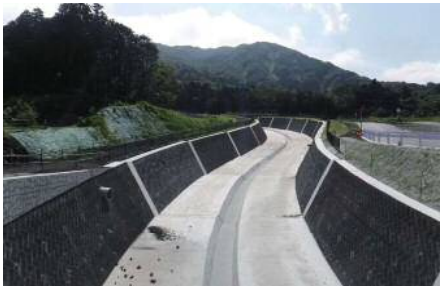
特定緊急砂防事業(導流堤整備)(大金沢 大島) 平成25年の土砂災害からの復旧のため、短期対策(平成26年度～平成28年度)として導流堤及び山腹工の工事を実施した。
