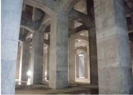
善福寺川調節池(貯留量約35,000m 3 )(杉並区成田西四丁目地内) 善福寺川上流の浸水被害を早期に軽減するため、都立善福寺川緑地内に貯留量約35,000m 3 の地下式の調節池を整備している。
