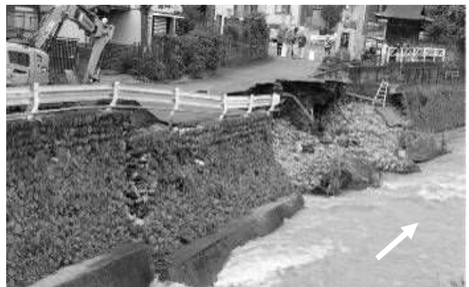
写真-1 被災翌日の状況
