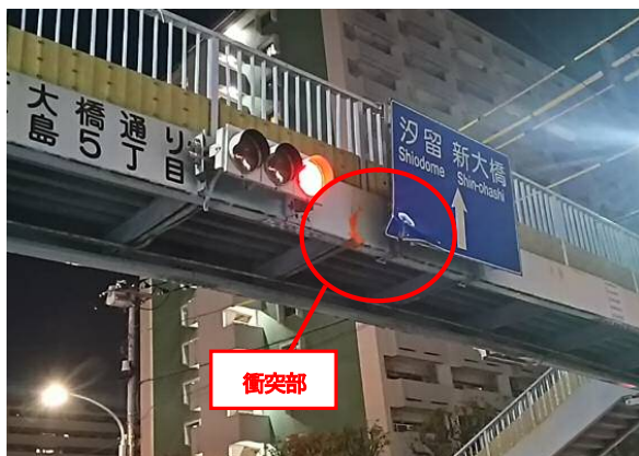
写真-1 主桁衝突部
