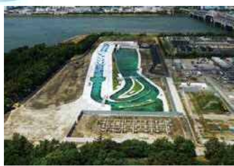
葛西臨海公園 カヌー・スラロームセンター(江戸川区) 葛西臨海公園隣接地において、東京2020大会時のカヌー・スラローム会場となるスラロームコースの整備が完了した。
