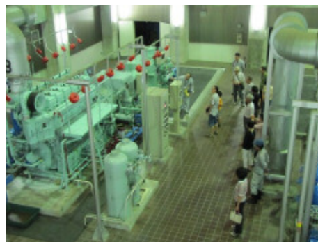
清澄排水機場監視室
