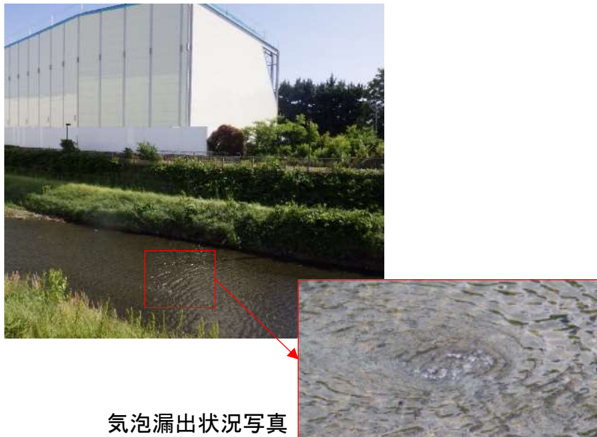
東名JCT周辺の野川の漏気状況
