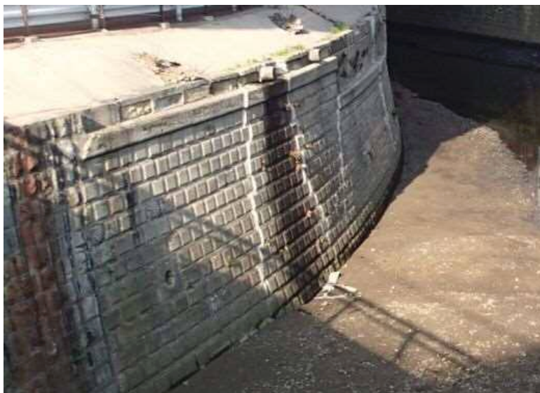
写真2-9 古川の護岸が老朽化した状況
