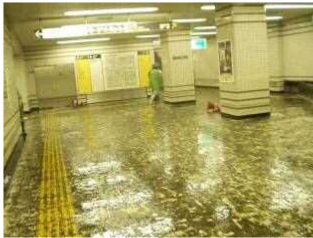
写真 2-2 平成 16 年 10 月 9 日台風 22 号による地下鉄南北線麻布十番駅 コンコース広場の浸水状況
