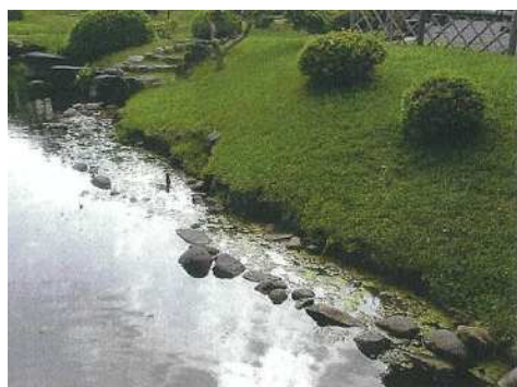
図 3-11 小池護岸（修復前） （平成 19 年）
