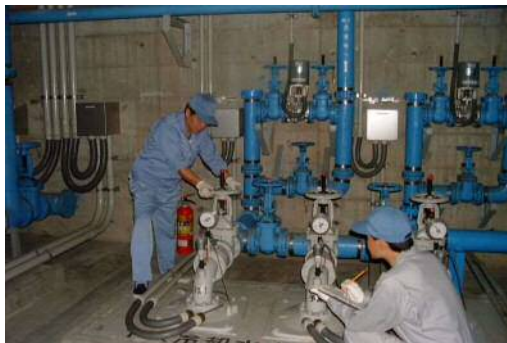
排水機場冷却水系統点検
