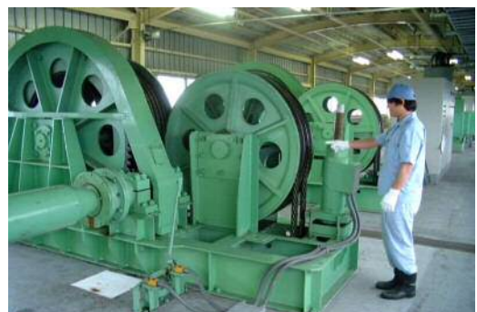
水門上屋設備点検
