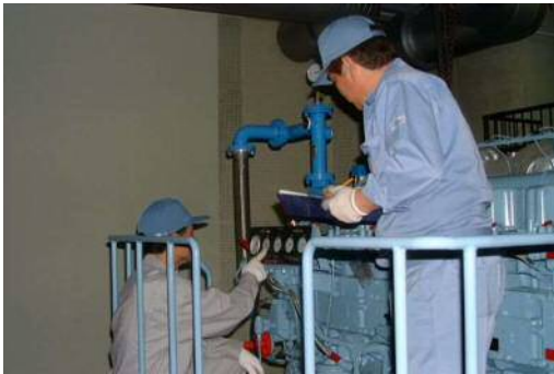
排水機場エンジン点検
