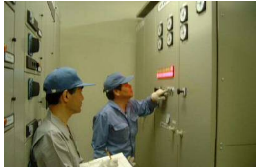
電気設備点検
