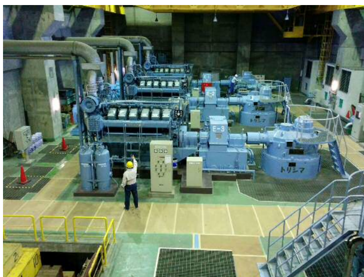
木下川排水機場内部
