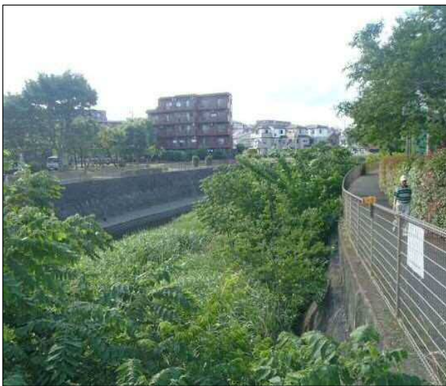
現在の河道内樹木の繁茂状況 (西田スポーツ広場前; 金山橋上流)
