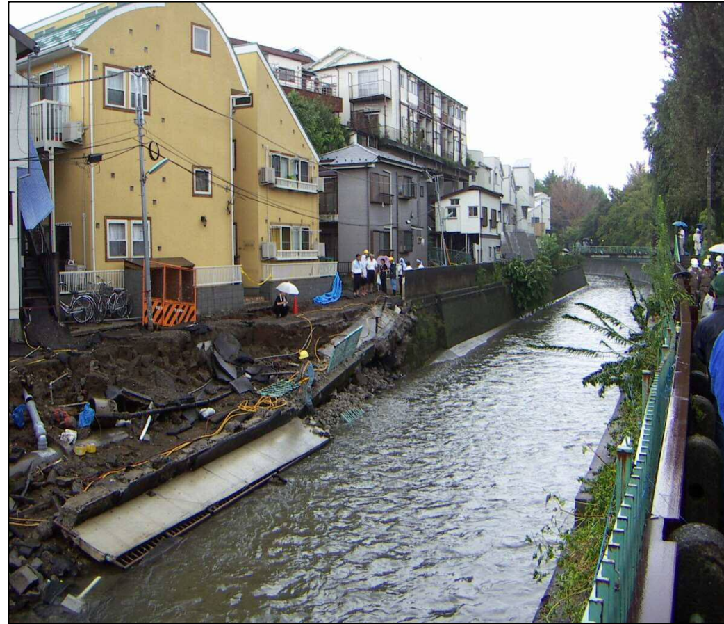
H17.9.4 の被害状況（妙正寺川）
