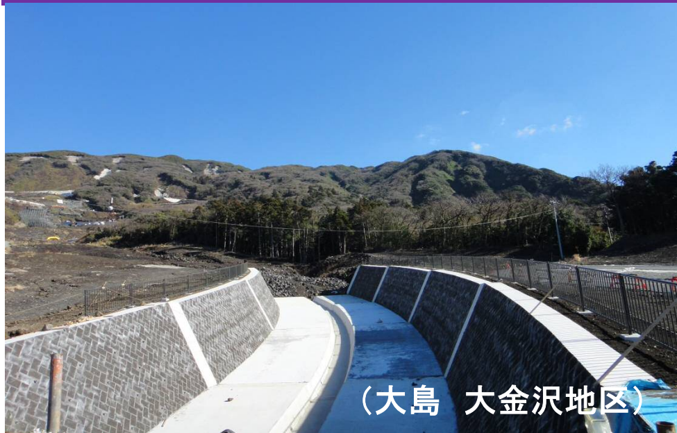
土石流の流れる方向を制御する導流堤
