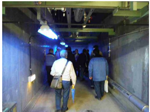
オゾン設備棟 (オゾン処理槽)
