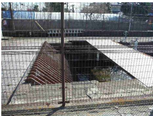
玉川上水上流部スクリーン
