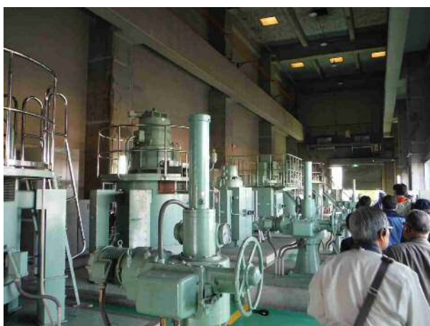
電動機室（沈砂池）
